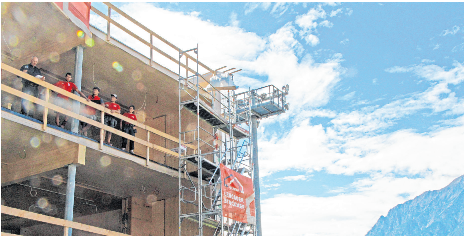
Am Bischöflichen Gymnasium Paulinum in Schwaz entsteht derzeit ein klimazertifizierter Zubau in Massivholzbauweise unter Verwendung regionaler und nachhaltiger Materialien.
